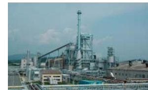
自家発電設備
